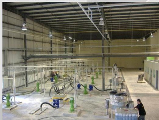
STABILIMENTO CHIAVI IN MANO COMPLETO DI IMPIANTI ELETTRICI E MECCANICI (MESSICO)
