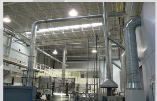
IMPIANTI MECCANICI ED ELETTRICI (MESSICO)
