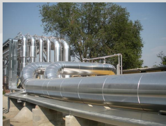
IMPIANTO DI TELERISCALDAMENTO (ITALIA)
