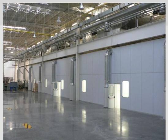
Impianti tecnologici stabilimento farmaceutico - CAMERE BIANCHE - MAIN CONTRACTOR - MONTERREY MEXICO
