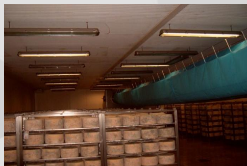
Condizionamento caseifici processo stagionatura formaggi molli con controllo T 1/10°- ITALIA
