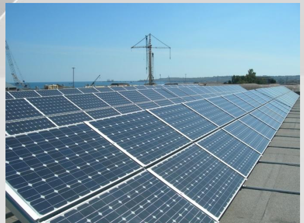
Impianto fotovoltaico da 50 kWp - Sicilia
