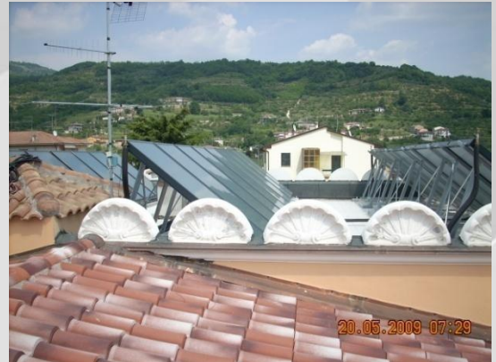
Impianto solare termico da 30 mq - Lombardia
